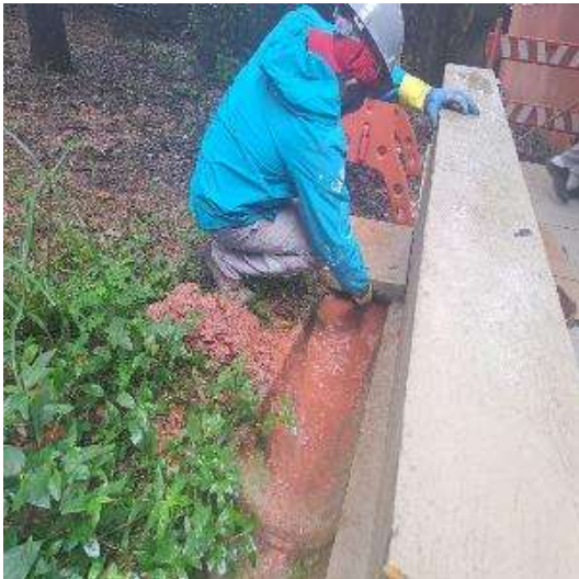
Figura 125: limpeza das calhas com acúmulo de terra
