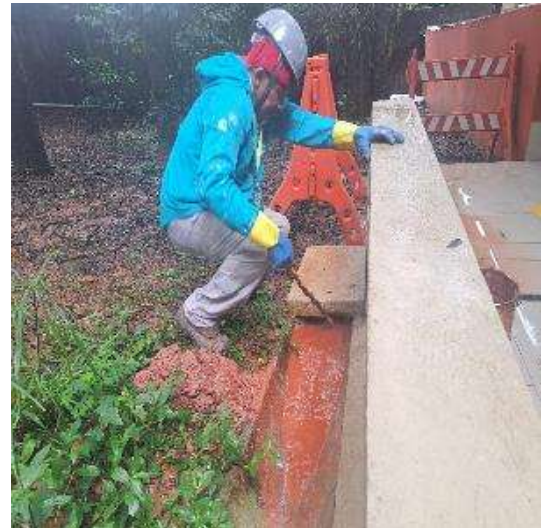
Figura 126: limpeza das calhas com acúmulo de terra
