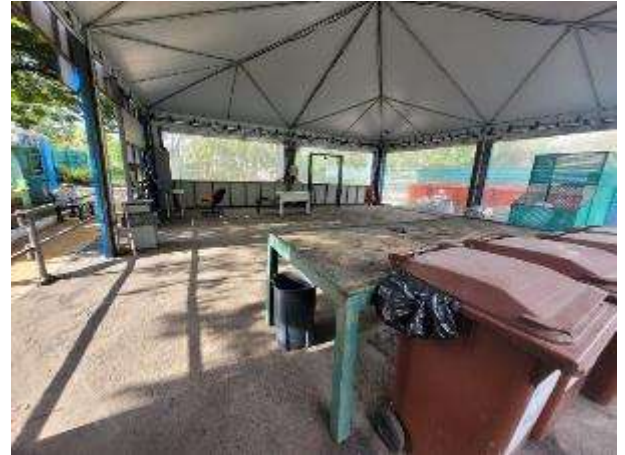
Figura 191:192 Central de triagem de resíduos
