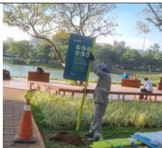
Figura 156: Manutenção de placas
