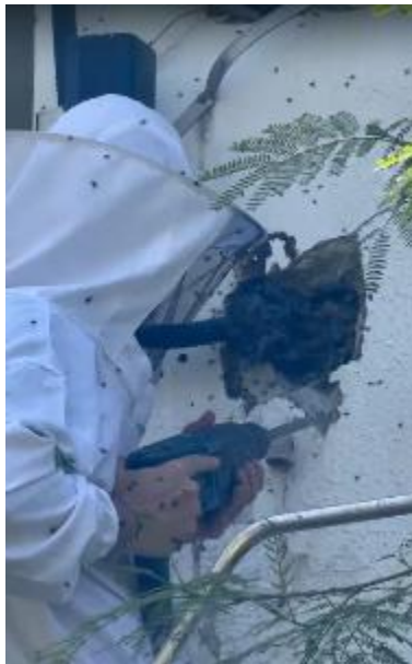
Figura 109: Remoção das colônias de Boca-de-sapo ( Partamona helleri ) do forro da obra da Marquise, onde foi necessário quebrar alguns blocos para a extração e destinação da colmeia, minimizando os danos.
